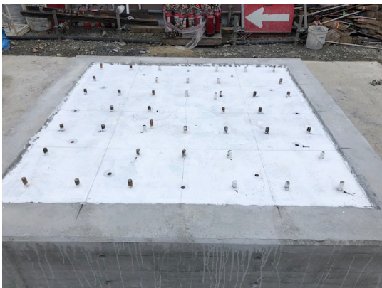
写真-6 3 回目試験後基礎表面状況
