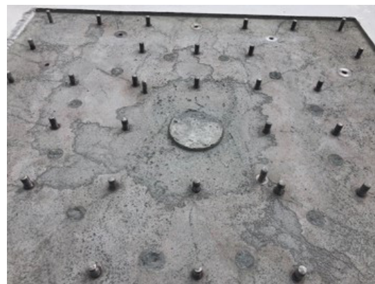
写真-4 2回目試験後基礎表面状況
