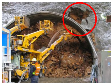
写真-1 切羽天端部崩落の状況
