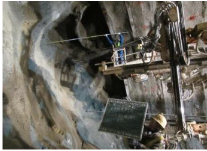
写真-2 鏡面の崩落状況
