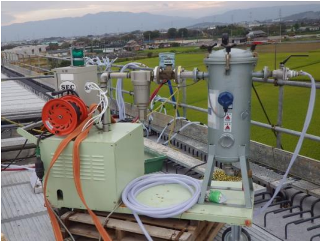
写真-3 真空ポンプ
