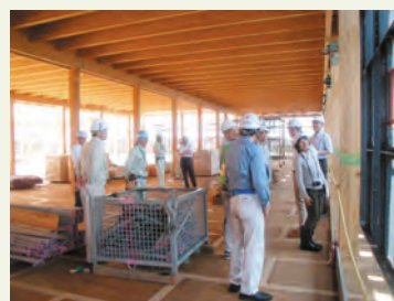
大学生を対象とした見学会（埼玉・東部地域振興ふれあい拠点施設工事）
