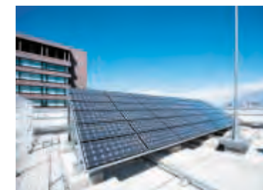
太陽光発電システム
