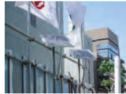
太陽光パネル （環状二号地下トンネル築造工事）
