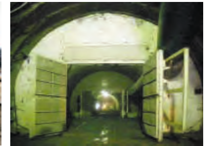
坑口に二重に設置した防音扉 （舞鶴若狭自動車道鈴ヶ嶽トンネル工事）
