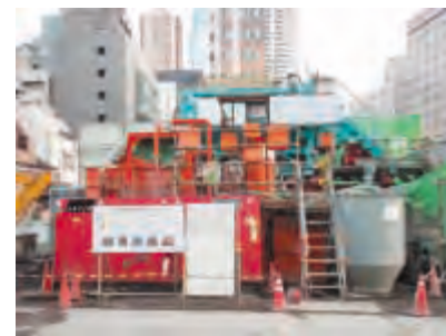
アクアセパレートプラント全景 （環状二号地下トンネル築造工事）
